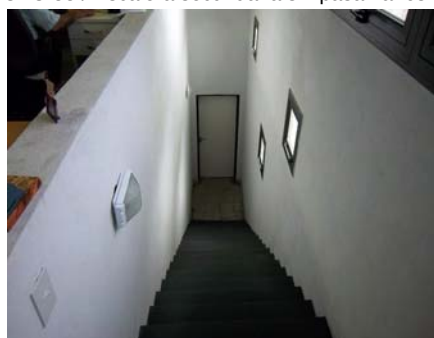
FOTO 38 / Escalera secundaria sin pasamanos (q) 132
