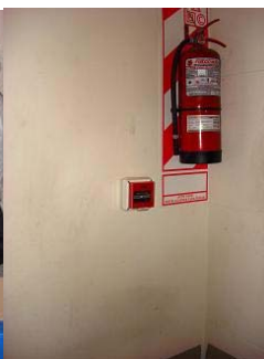
FOTO 24/ Extintor c/ incendios
