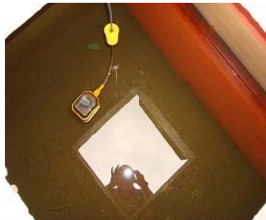
FOTO 45/ Flotador Tanque de agua Azotea
