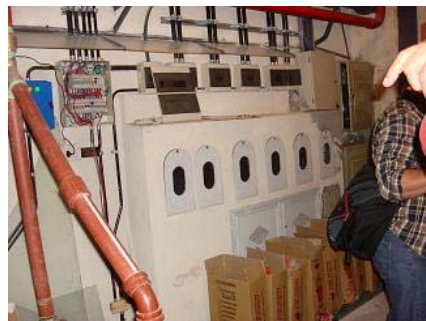
FOTO 11 / Subsuelo Medidores de Luz.(c)
