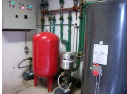
FOTO 41 / Sistema contra Incendio
