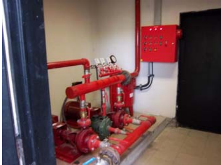
FOTO 40 / Sistema contra Incendio
