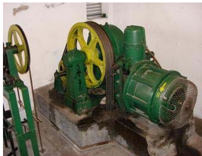
FOTO 46 / Motor caja de ascensores.
