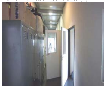
FOTO 14/ Paso insuficiente (h) 124
