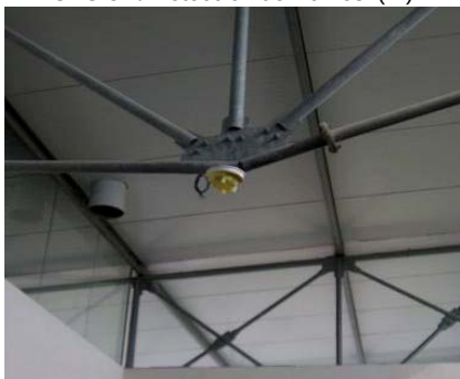
FOTO 31 / Detección de Humos. (m) 129
